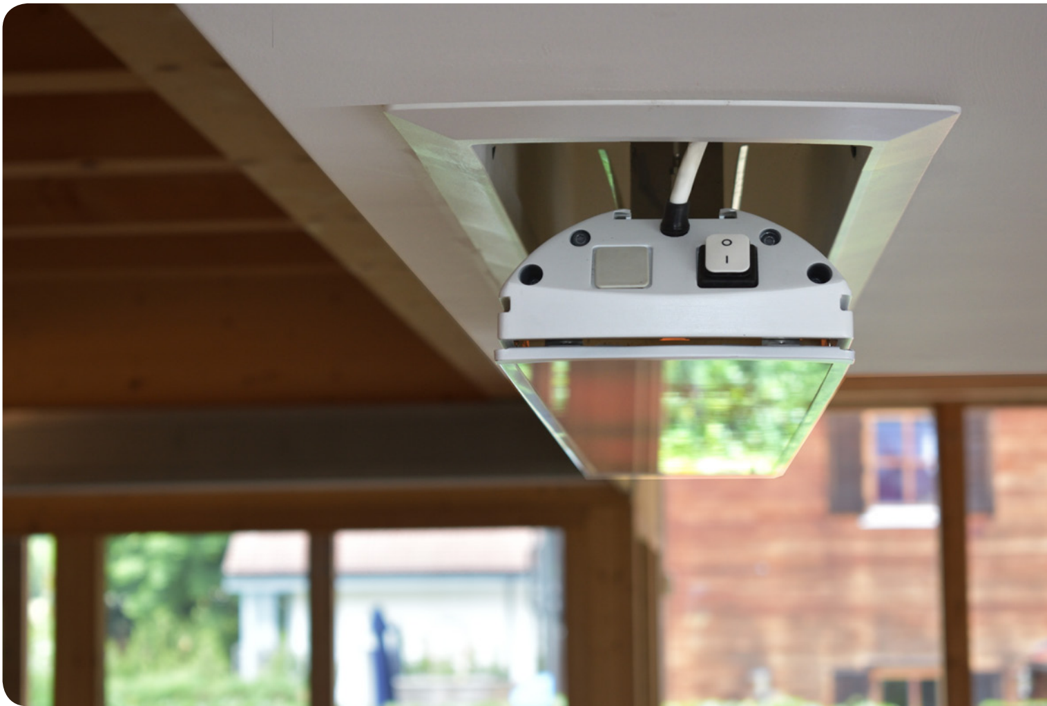
Flächenbündiger Deckeneinbau, Sauerlach · Deutschland
